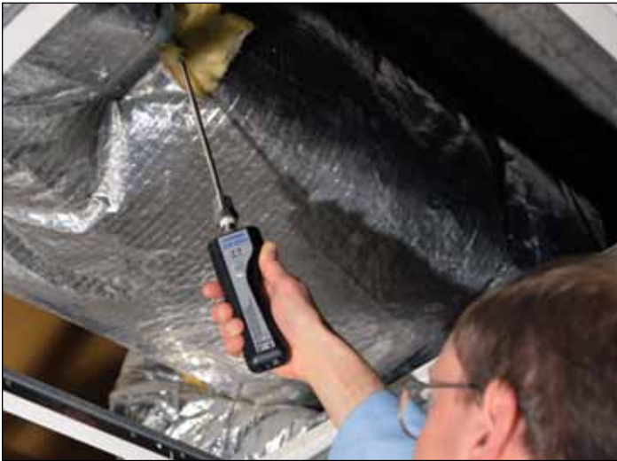
Figura 1: medición de la temperatura en un conducto de aire con UWBT-RTD-M12
